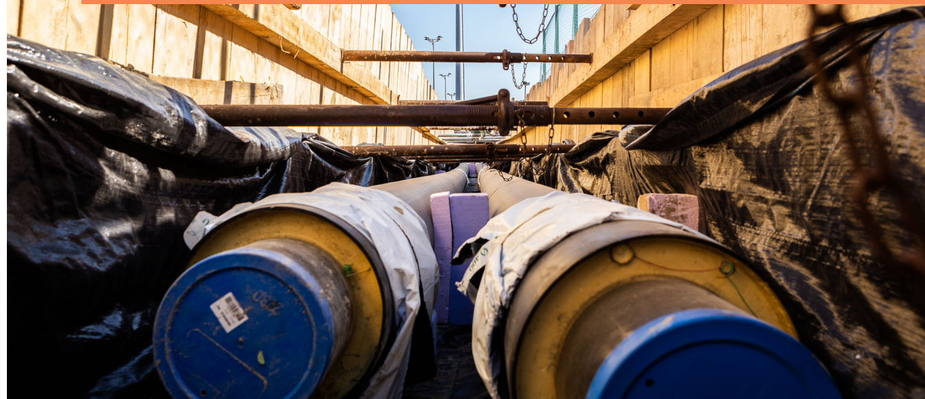
CHAUFFAGE À DISTANCE (CAD) PIERRE DE SAVOIE & STADE, YVERDON-LES-BAINS
